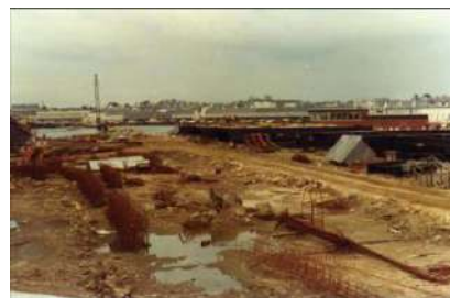
L'élévateur à bateaux dans l'anse de Roudouic. Réception définitive des travaux en 1980.
