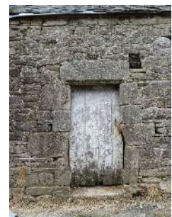
Porte à encadrement chanfreiné sous linteau monolithe daté de 1737. Maison élémentaire à Roz Bihan.
