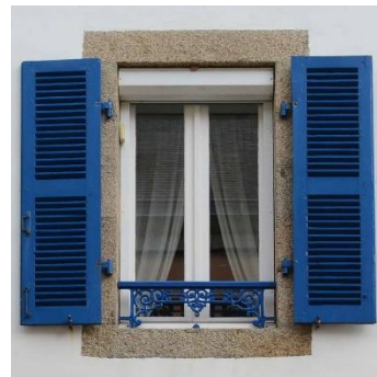
Le volet roulant est incompatible avec la forme des fenêtres classiques. De plus le coffre est en saillie par rapport à la menuiserie.
