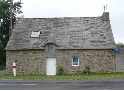
Simple soulèvement de rive de toiture
